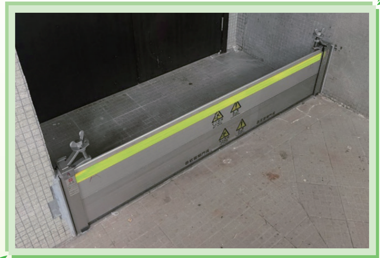
富豪機場酒店的防洪閘
